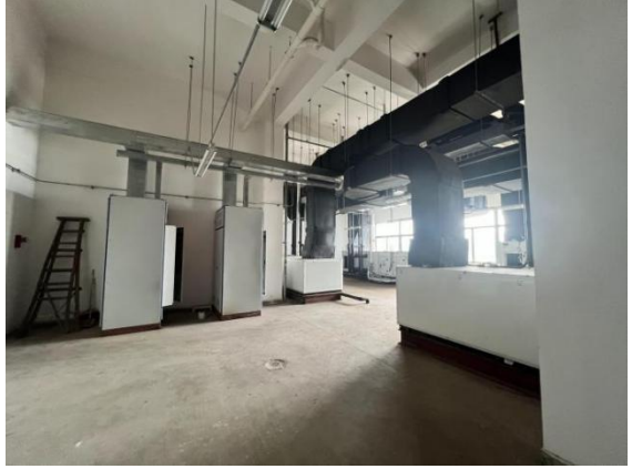
拟建场所楼上设备间
